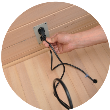
Zapojené káble ohrievačov
